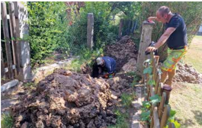
Wasserrohrbruch in der Jahnstraße
