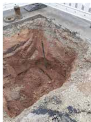
Wasserrohrbruch in der Blumenstraße
