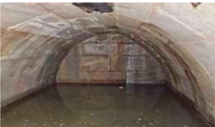
„Geheimnisvoller Keller am Marktplatz“: Bei Bauarbeiten am Marktplatz entdeckte man einen unbekanntem Keller, der anschließend denkmalgerecht wieder verfüllt wurde, damit er später wieder freigelegt werden kann.
