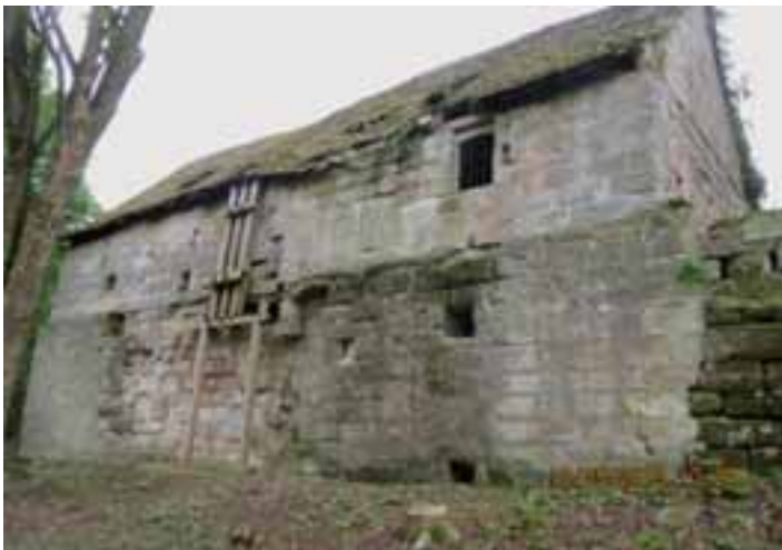
Der Schlossstadel heute von Nord. Zum Teil ist Vormauerung – Schlossbau 1493 – herausgebrochen und darunter ist die Originalmauer zu sehen.
